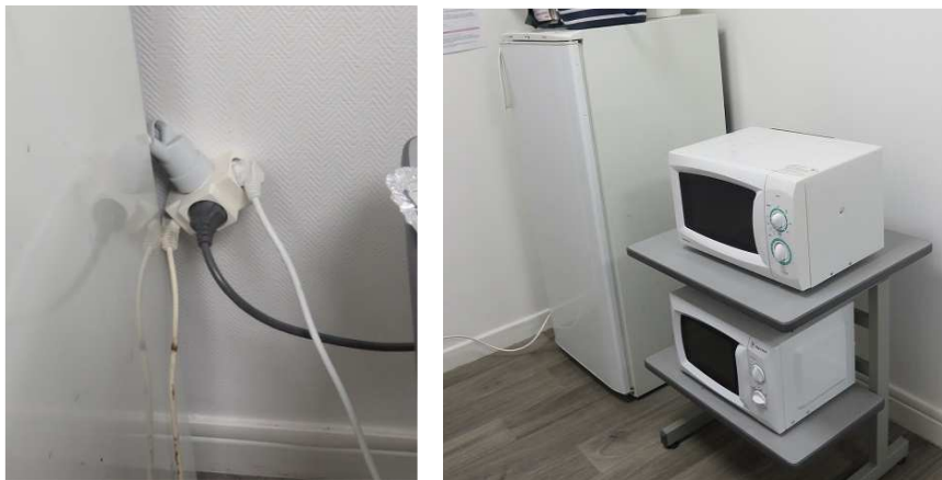
Ci-dessus, situation de surcharge constatées dans le local café du rez de chaussée
