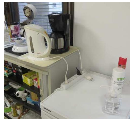
Ci-dessus, situation de surcharge constatées dans le local détente du SDIF au 2 ème étage.
